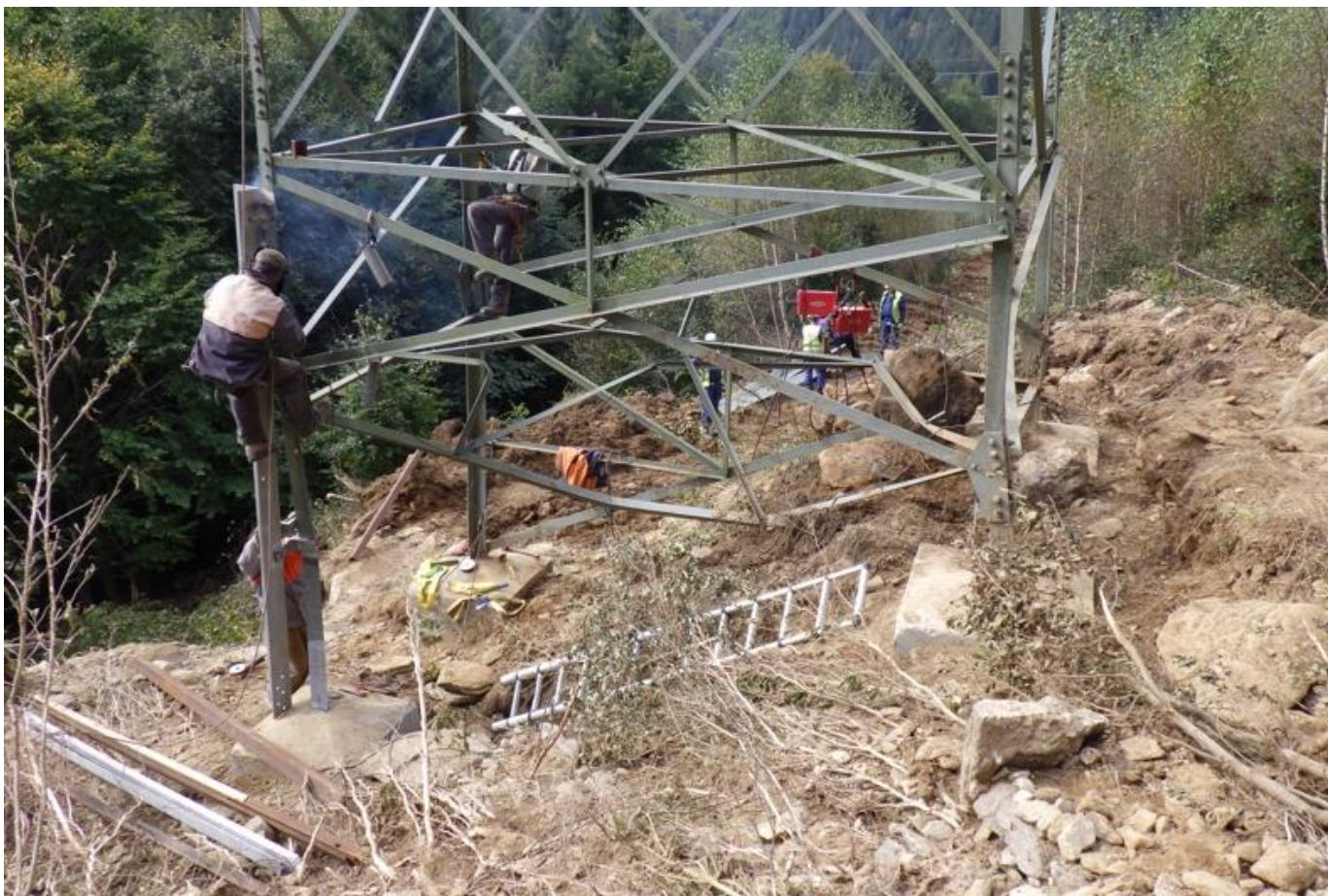
Povodně 2024. Pohled na nepoškozené patky stožáru V457_=CD218-UFJ(127). K ohybu spodních nosných částí konstrukce došlo po úderu větších kamenů a nedošlo k jejich posunu. Mohlo dojít k vyplavení jemných částic z podloží patek a k jejich nepatrnému poklesu. Foto O. Krejčí 23. 9. 2024.
